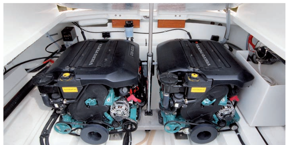
Gut zugänglich und sauber installiert: Die Motoren. Hier die Doppelmotorenanlage der 300 R.
